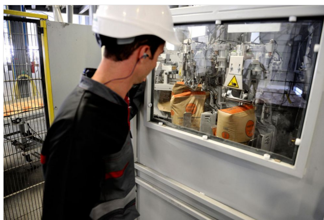
© Gaël Kerbaol/INRS - 2013 Ensachage mécanisé de ciment afin de réduire les émissions de poussières dans une cimenterie
